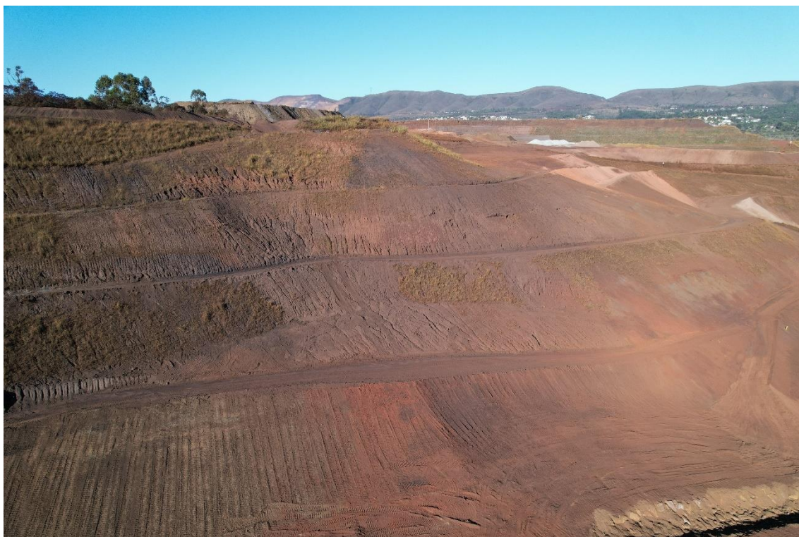
Figura 24 - Taludes escavados junto ao antigo reservatório da Barragem B1 (ombreira esquerda). Presença de sulcos erosivos devido a não revegetação dos taludes.
